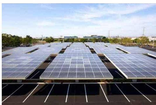
駐車場での太陽光発電
