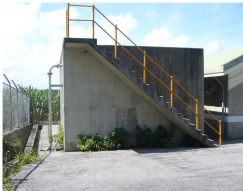
糸数ポンプ井 RC造 V=90m 3 (平成11年3月建設)
