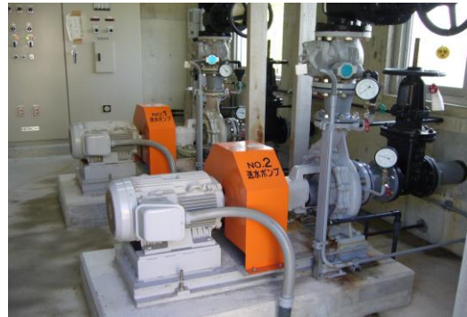
糸数送水ポンプ P=15kw-2台
