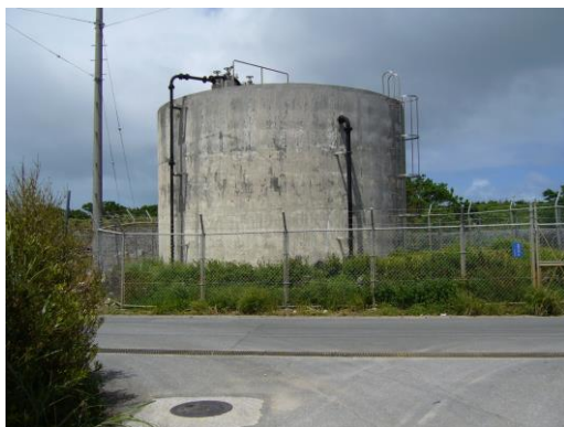
A配水池 RC造 V=221.17\text{m}^3 (昭和52年1月建設)
