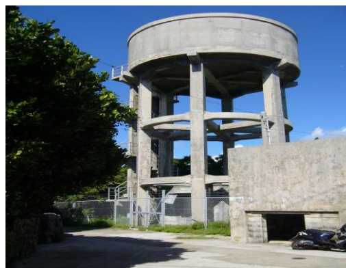
久高高架水槽 RC造 V=90.39\text{m}^3 (昭和52年度建設)
