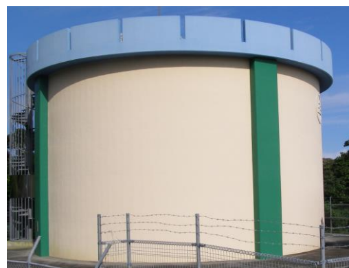
仲村渠配水池 PC造 V=810\text{m}^3 (平成13年3月建設)
