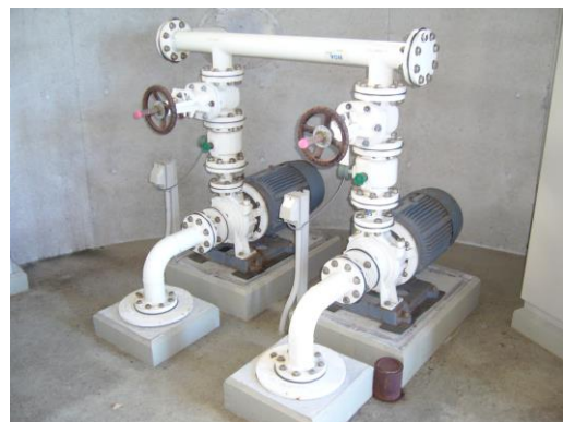
つきしろ送水ポンプ P=11kw-2台
