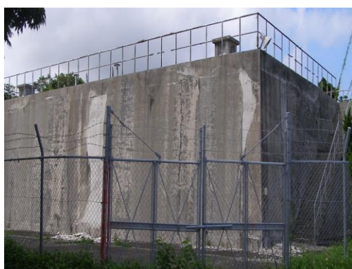
糸数配水池 RC造 V=1,575\text{m}^3 (昭和52年3月建設)
