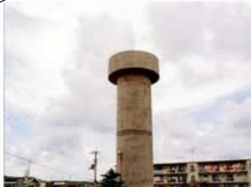
嶺井団地高架水槽 100m 3 平成 58 年建設
