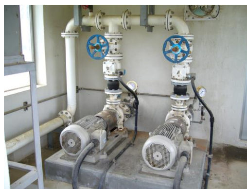
親慶原ポンプ P=11kw-2台
