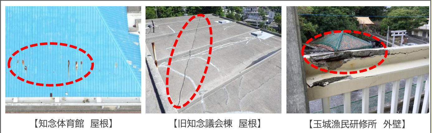
図表3. 劣化(老朽化)状況調査 現地写真例
