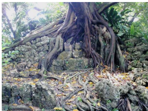
樹根による破壊が懸念される事例(大里字西原 先之世之主の墓)
