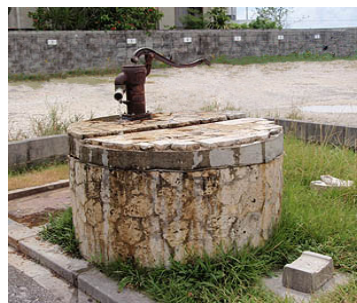
手こぎポンプ設置例(浦添市経塚)
