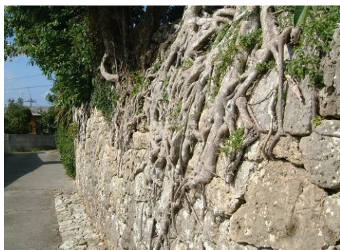
ガジュマルの根がはりついた事例(玉城字前川)
