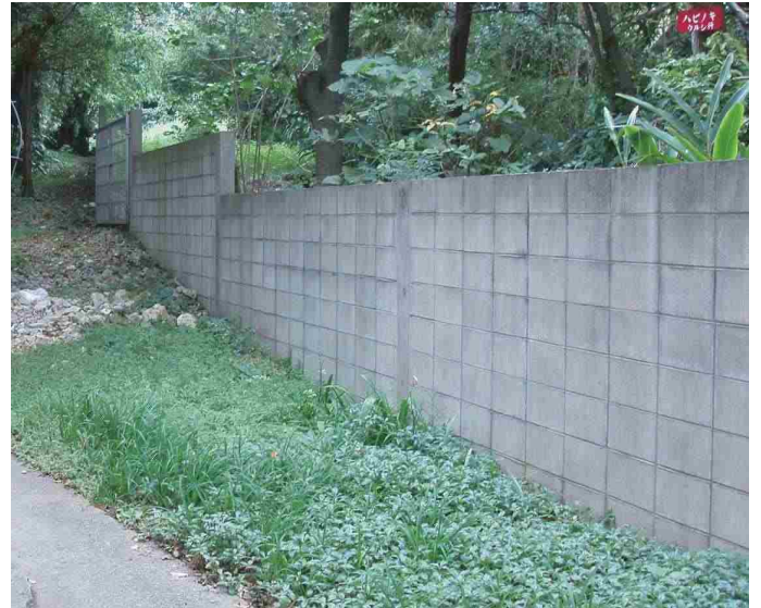
ハブの侵入を防ぐブロックべい
