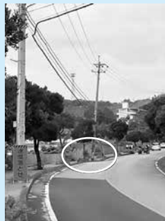
大里中学校から与那原向け通学路陥没箇所
