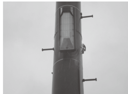
故障で点灯しない防犯灯
