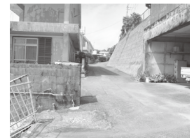
中山地域崩落寸前箇所
