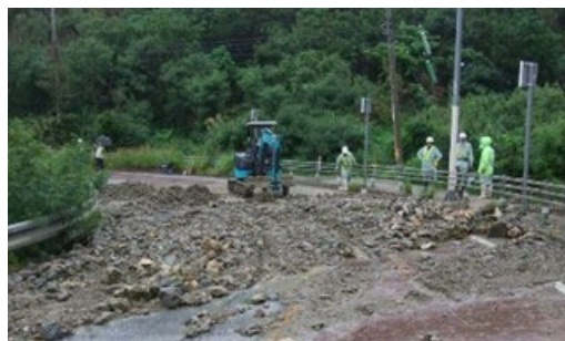
写真 土砂災害の状況
